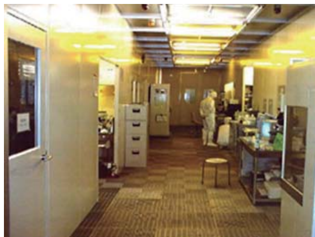
図 5 ケミカルフィルター設置のスーパークリーンルーム
