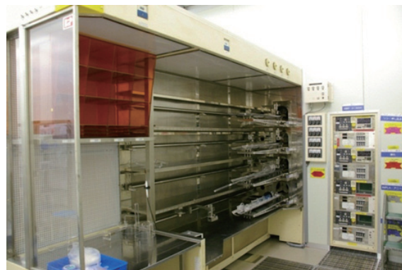
図3 ボロン拡散炉
