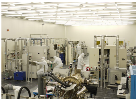
図1 クリーンルームの様子
